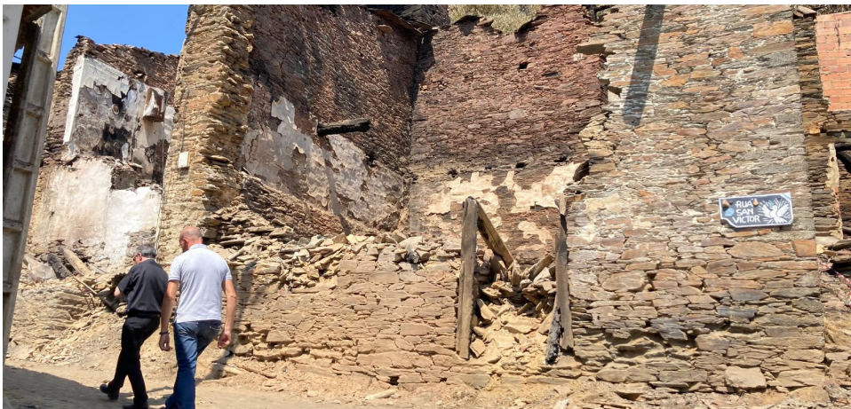
Visita por las calles afectadas de la localidad
